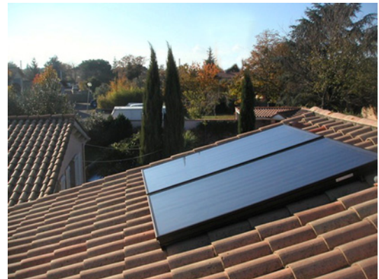
Photographie 1 : Chauffe-eau solaire individuel (4 m 2 de capteurs)
