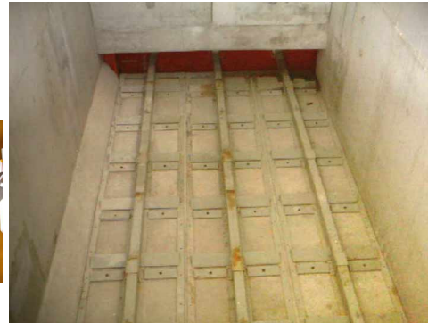
Extracteur à échelle (disposé en fond de silo)
